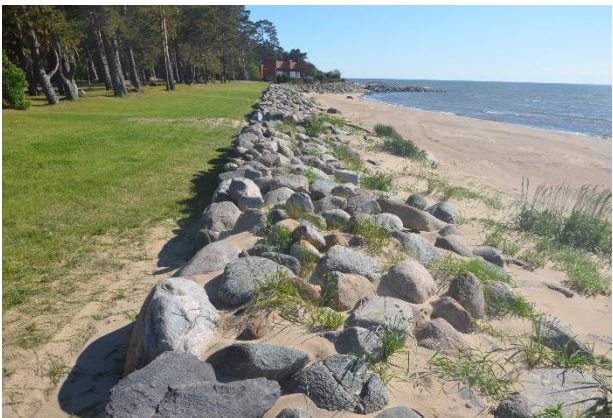
Foto 4.15. Vaade lõunasse Lapanina hotelli suunas Kabli külas. Liivase maatüki uhtumist on välditud kividest rannakindlustusega. 06.06.2020.
