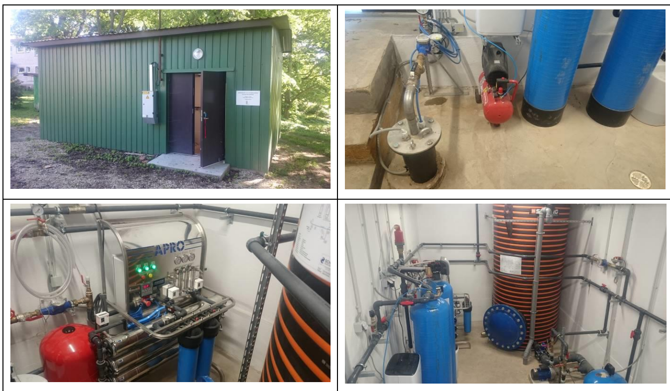
Joonis 22. Treimani Keskuse puurkaev (katastri nr 6567) ning veetötlusjaam. Fotod: OÜ Alkranel 21.05.2018.
