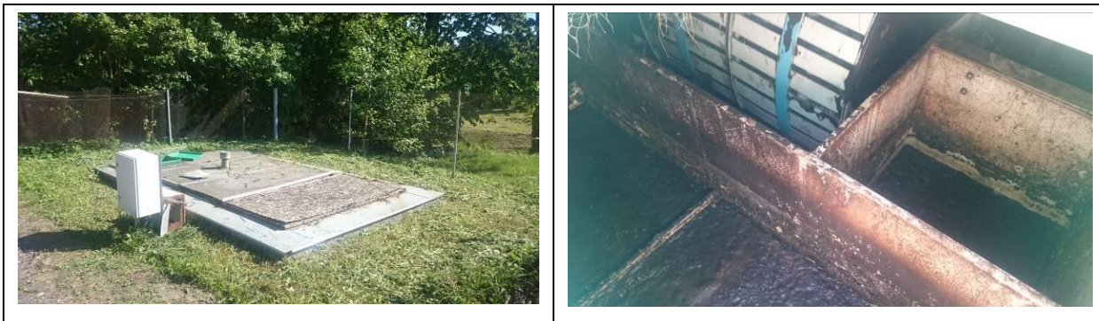
Joonis 25. Treimani reoveepuhasti. Fotod: OÜ Alkranel 21.05.2018.
