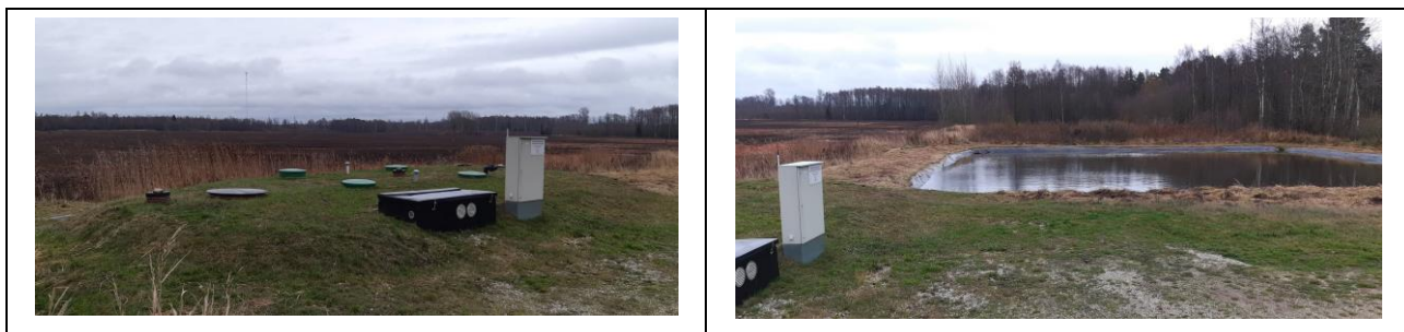
Joonis 21. Kabli küla reoveepumpla ja -puhasti. Fotod: OÜ Alkranel 21.05.2018.
