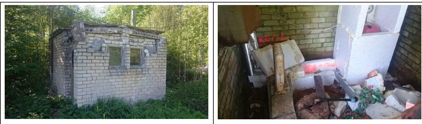
Joonis 27. Massiaru Viira puurkaev-pumpla (katastri nr 7623). Fotod: OÜ Alkranel 21.05.2018.
