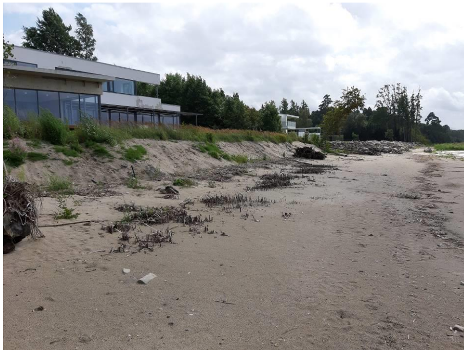
Foto 2.4. Vaade Kulla tee 5 kinnistule, mille merepoolset osa on kõrge vee seisu ajal lained murrutanud. Paljandunud on kohevad peenliivad, mille alla (alates -21 cm EH2000) jääb REI Geotehnika uuringu andmeil voolav savi. Tagaplaanil on näha Kulla tee 7 kinnistut, mille nõlv on graniitkividega kindlustatud.
