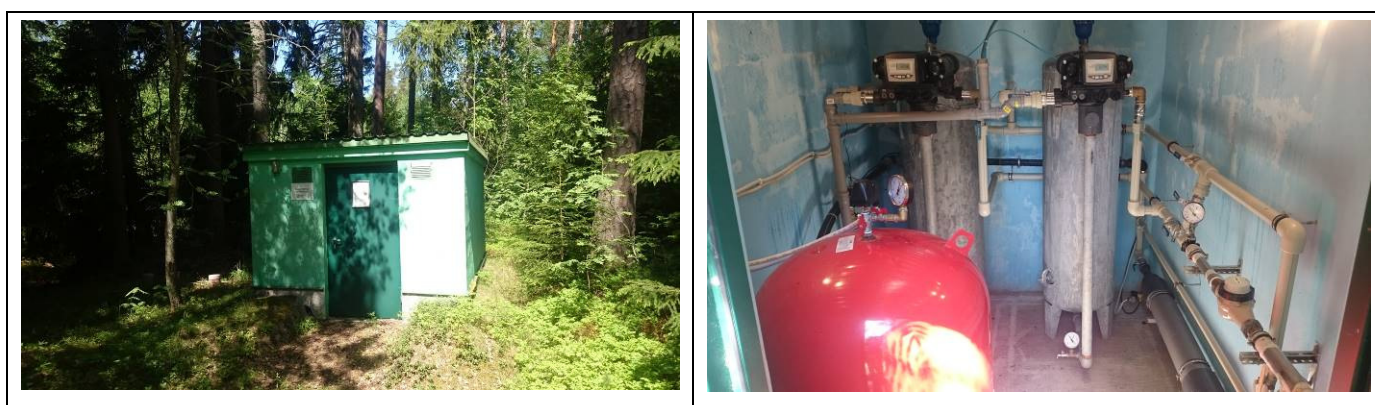
Joonis 16. Reiu küla Sukumetsa puurkaev-pumpla (katastri nr 20069 ning veetötlusjaam). Fotod: OÜ Alkranel 21.05.2018.
