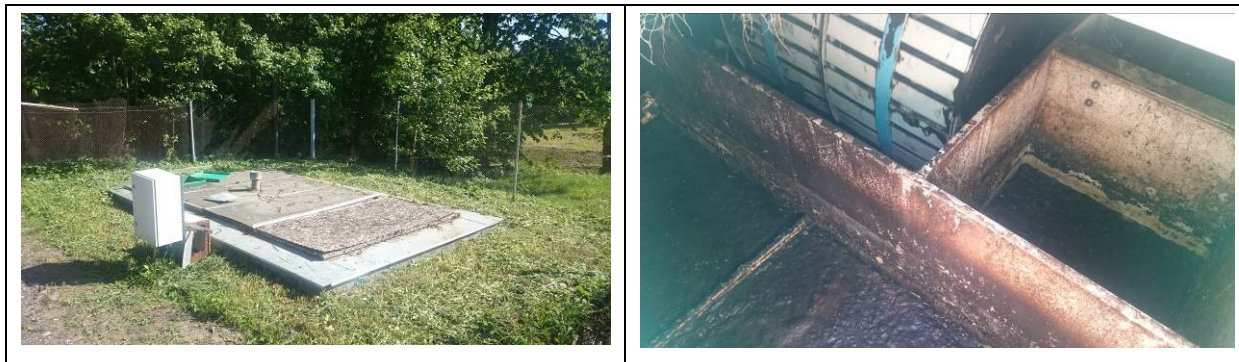
Joonis 25. Treimani reoveepuhasti. Fotod: OÜ Alkranel 21.05.2018.
