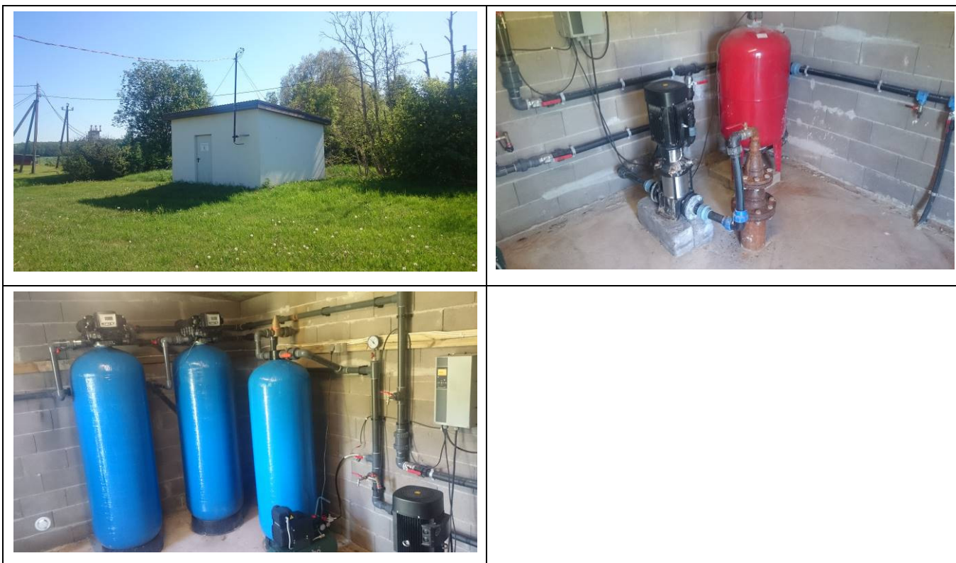
Joonis 20. Kabli küla puurkaev (katastri nr 6571) ning veetöötusjaam. Fotod: OÜ Alkranel 21.05.2018.
