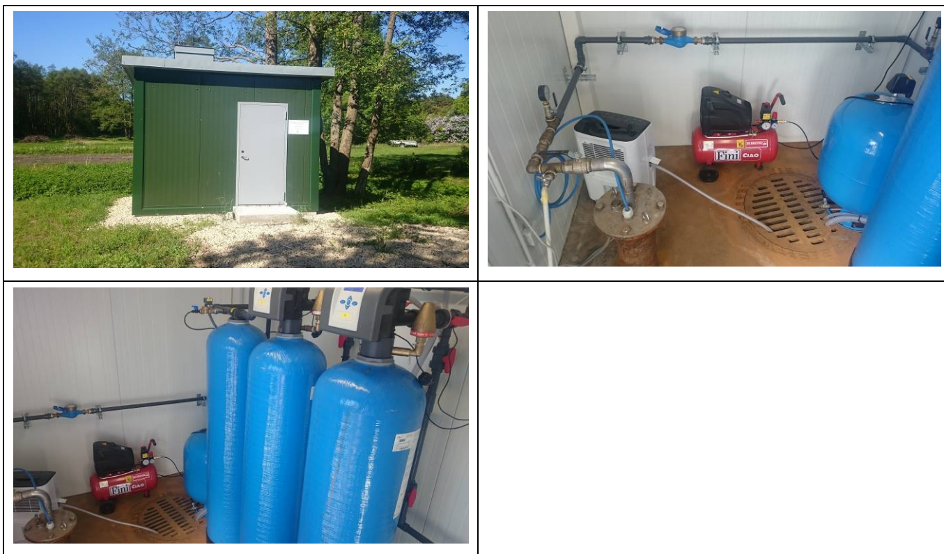
Joonis 29. Ikla Keskuse puurkaev (katastri nr 7715) ning veetötlusjaam. Fotod: OÜ Alkranel 21.05.2018.
