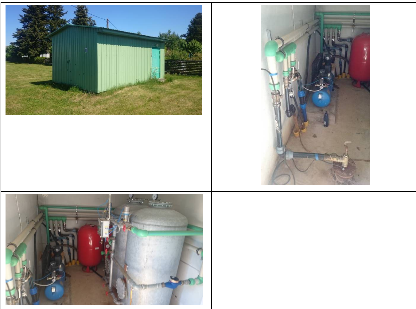
Joonis 13. Võiste aleviku Külmhoone puurkaev-pumpla (katastri nr 6459) ja veetötlusjaam. Fotod: OÜ Alkranel 21.05.2018.
