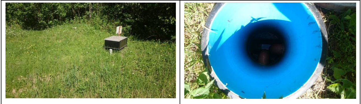
Joonis 17. Kulla tee reoveepuhasti. Fotod: OÜ Alkranel 21.05.2018.
