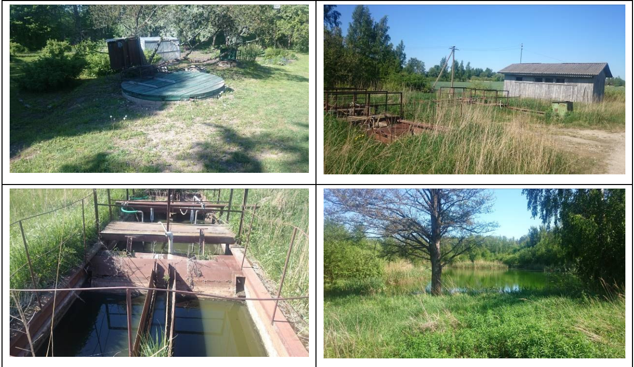
Joonis 21. Kabli küla reoveepumpla ja -puhasti. Fotod: OÜ Alkranel 21.05.2018.
