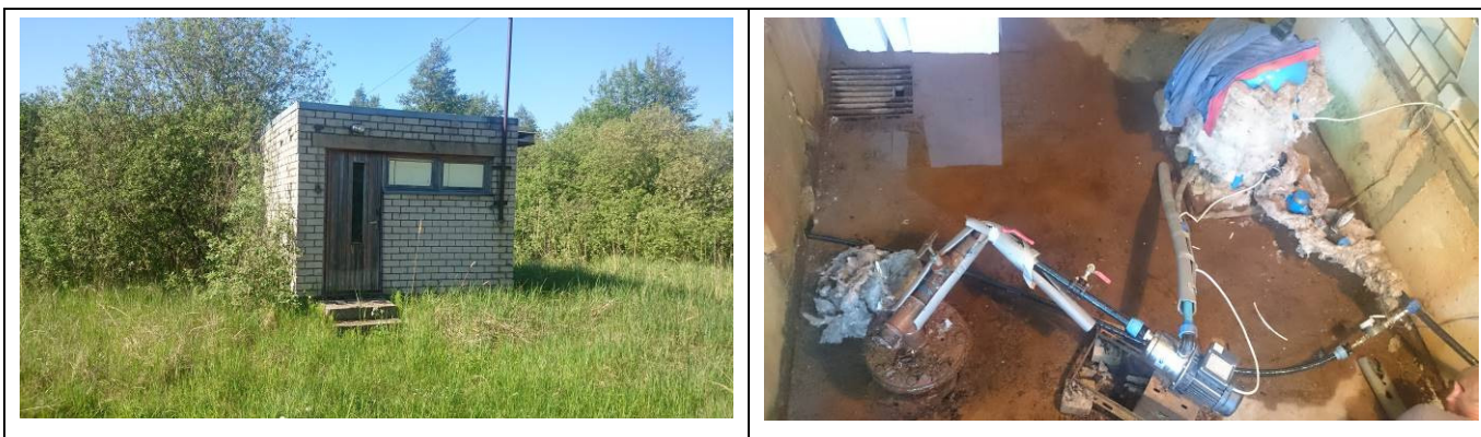
Joonis 30. Ikla Ridaelamu puurkaev-pumpla. Fotod: OÜ Alkranel 21.05.2018.
