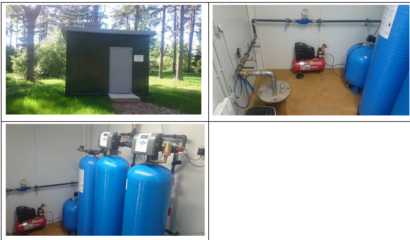
Joonis 26. Massiaru Keskuse puurkaev (katastri nr 7624) ning veetötlusjaam. Fotod: OÜ Alkranel 21.05.2018.
