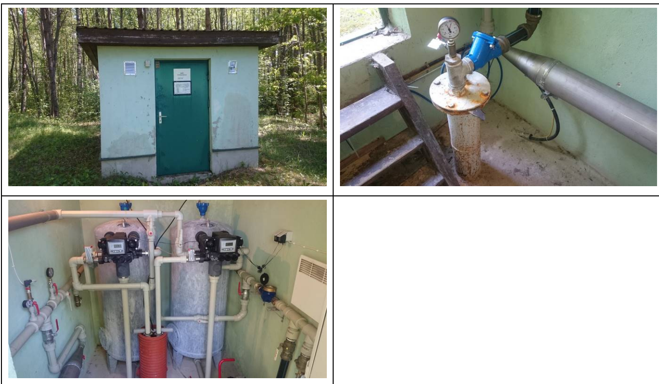
Joonis 15. Reiu küla Tõllapulga puurkaev (katastri nr 20915) ning veetötlusjaam. Fotod: OÜ Alkranel 21.05.2018.
